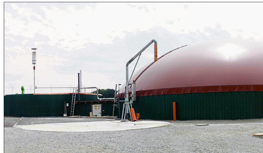
Die Biogasanlage von Xaver Mayer in Sondergai im Landkreis Straubing-Bogen. (Foto: privat)
